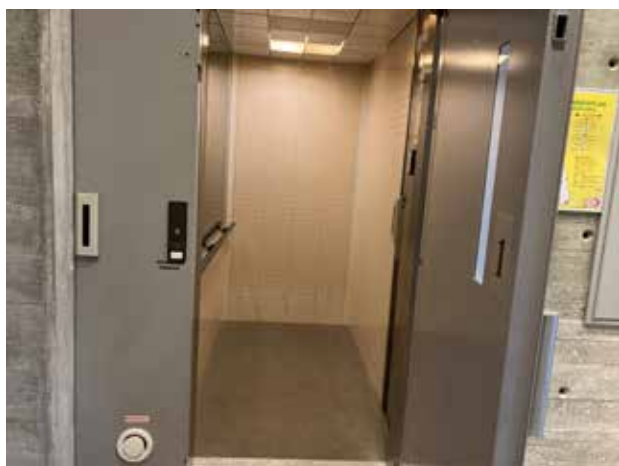
Hiss till övervåningen.
